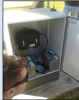
Aufzeichnungsausrüstung und Notstromversorgung für ein Seismometer im Golf von Korinth
