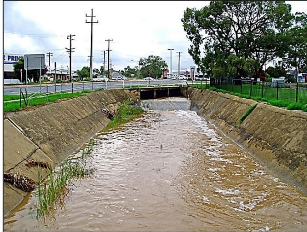
Figura 6.7. Dreno de tempestade, Dobney Avenue, Wagga Wagga, New South Wales, Austrália.
