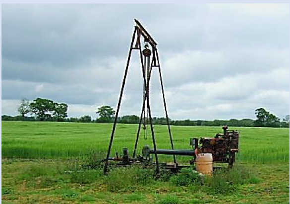
Bomba a diesel utilizada atualmente, Inglaterra.
