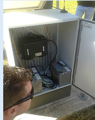
Equipamento de gravação e fornecimento de energia reserva para um sismógrafo do Golfo de Corinto
